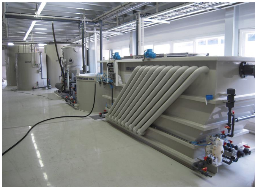
Čistírna odpadních vod
