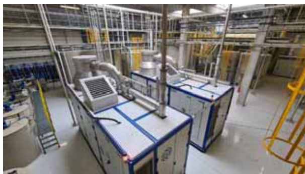
Obr. 8: Čistírna odpadních vod
