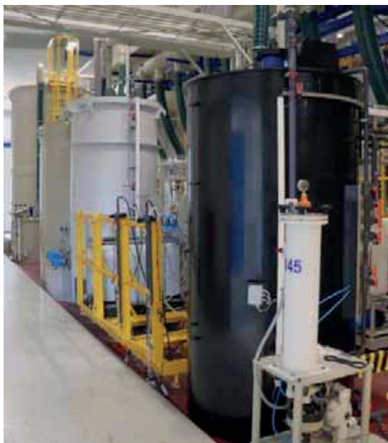
Obr. 6: Rezervní a přípravné nádrže, dávkování
