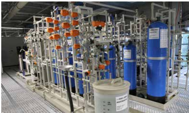
Cirkulační ionexová stanice
