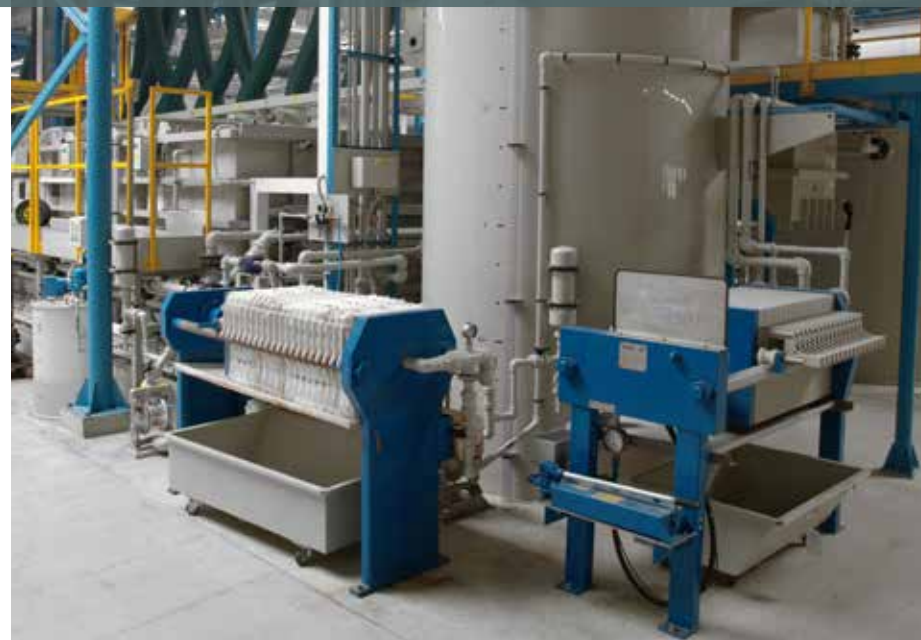
Odkalování fosfátovacích lázní
